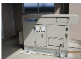
《非常用LPガス発電機(小高支店)》
